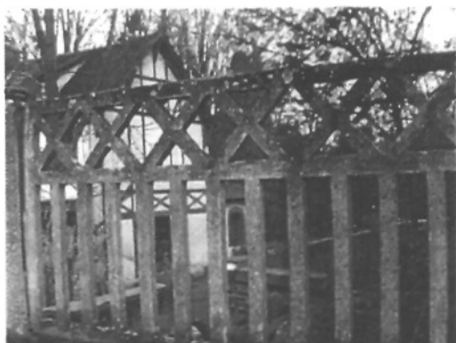
Habitation n°21bis rue du Moulin d'en Bas inondée lors de la crue de l'Yonne
