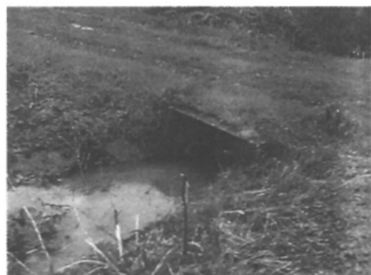
Dérivation du bras des Moulins vers celui des Marchands en amont de la RD 182
