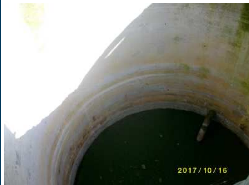
Photo 7. Silo à boues
