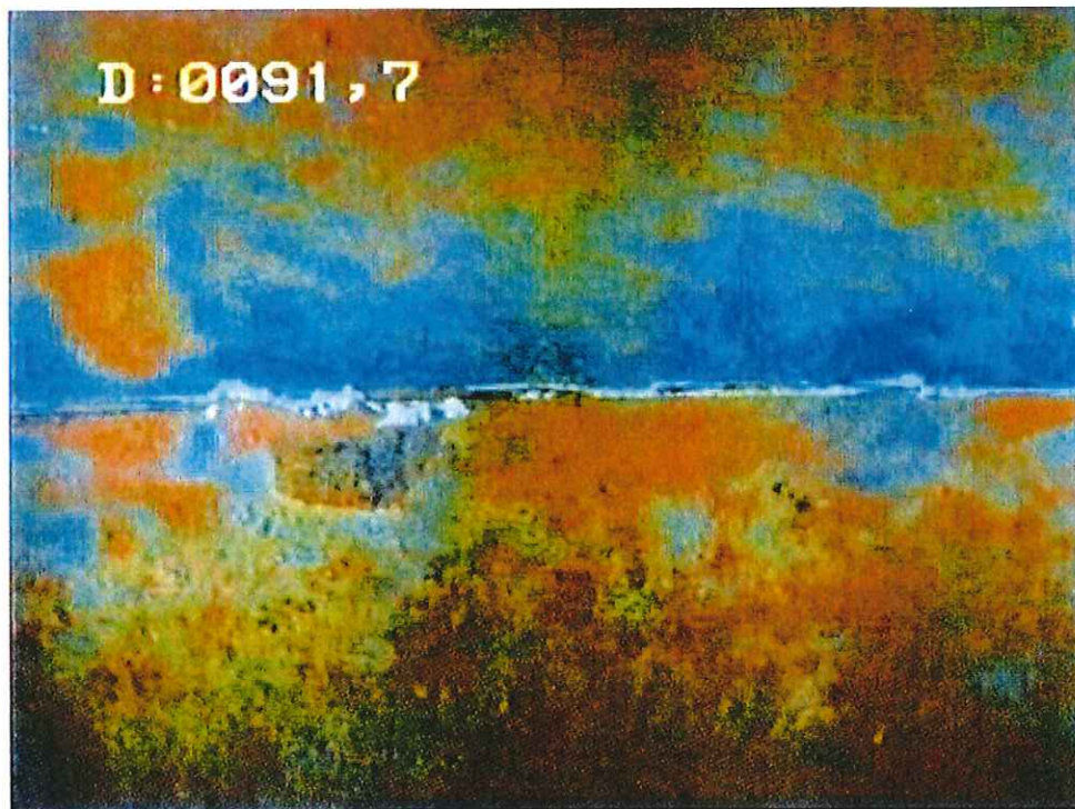
6- Tubage acier plein – légers dépôts et soudure inter-tubes
